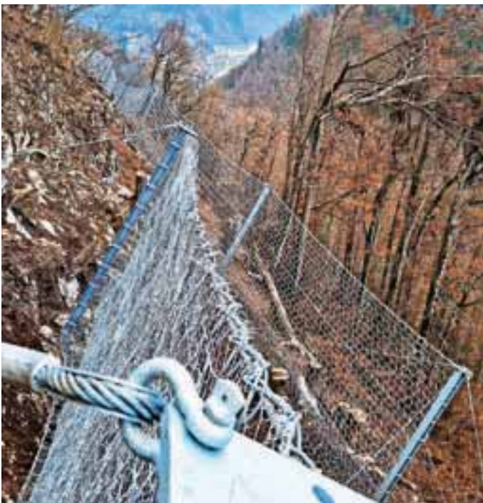
Tik pod zgornjimi skalnimi robovi so vgradili tri podajno-lovilne sisteme dolžine šestdeset metrov in višine pet metrov. / Foto: Eho Projekt
